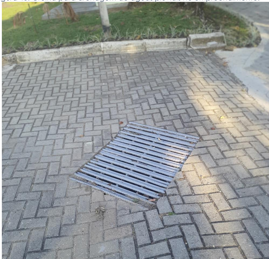
Figura 45: Grelha para drenagem de águas pluviais no empreendimento.
