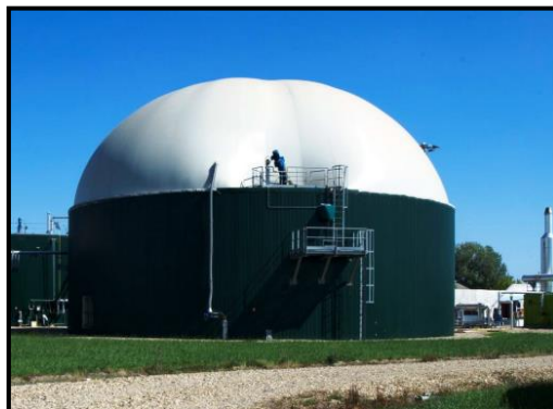
Figura 8 - Exemplo de pós-digestor que será instalado no empreendimento.
