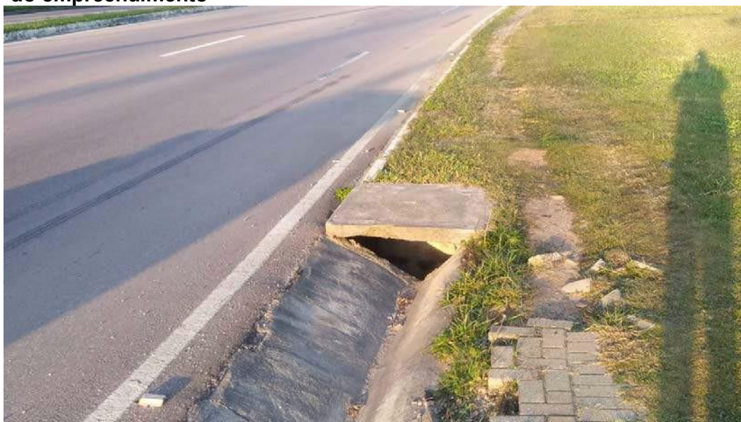
Figura 23 - Canaleta de drenagem de águas pluviais existente no entorno do empreendimento
