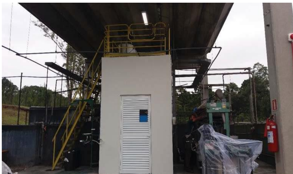
Figura 10 - Estação de Tratamento de Efluentes – ETE
