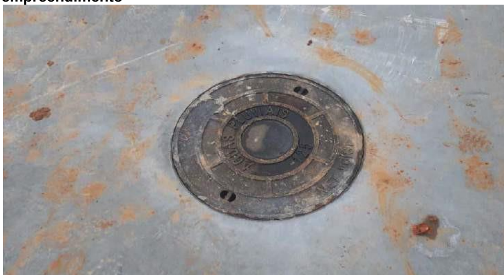
Figura 13 - Rede de drenagem de águas pluviais existente no empreendimento
