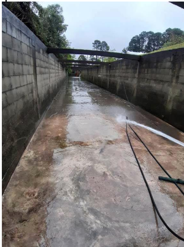
Figura 14 - Caixa de contenção de águas pluviais
