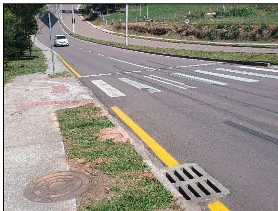
Fotografia 56. Galeria Pluvial localizado na AV. César Hasselmann Fonte: Acervo ANDES (2024).
