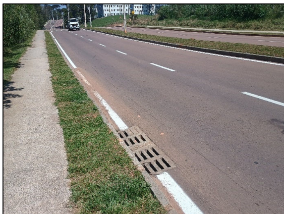
Fotografia 55. Galeria Pluvial localizado na AV. César Hasselmann. Fonte: Acervo ANDES (2024).
