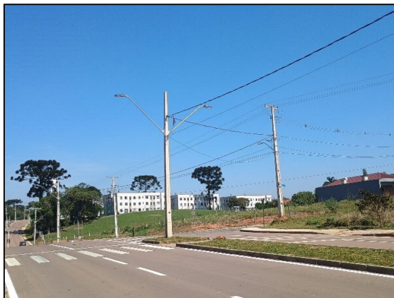
Fotografia 69. Poste de Luz localizado na Rua César Hasselmann. Fonte: Acervo ANDES (2024).
