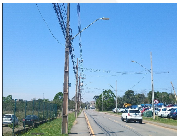
Fotografia 48 Postes de Energia localizado na Rua Pedro de Alcântara Meira. Fonte: Acervo ANDES (2024).
