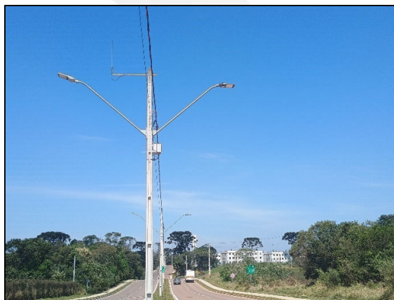
Fotografia 68. Poste de Luz localizado na Rua César Hasselmann. Fonte: Acervo ANDES (2024).
