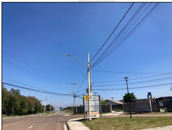
Fotografia 73. Poste de Luz localizado na Rua César Hasselmann. Fonte: Acervo ANDES (2024).
