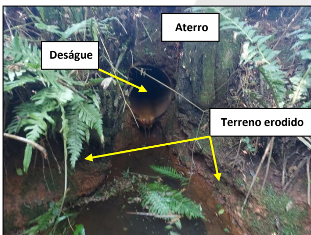
Fotografia 22: Deságue de manilha que passa sob a superfície aterrada (Andes Geologia, 2024).
