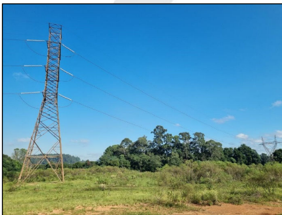
Fotografia 1. Torre de alta tensão localizada na porção sul do terreno no Ponto 1. Fonte: Acervo ANDES (2024).
