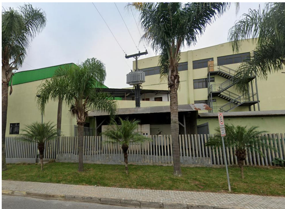
Figura 14: Entrada de energia em média tensão
