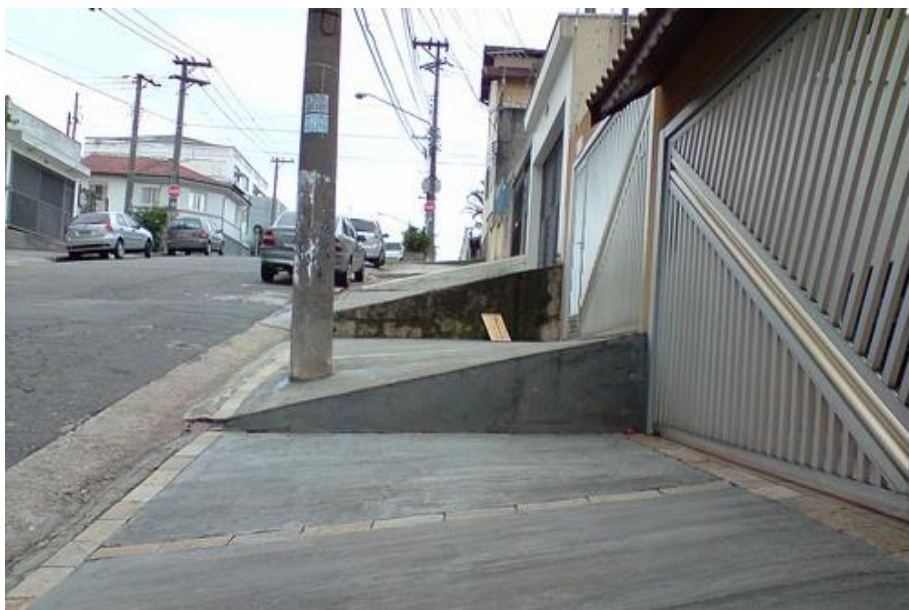
Figura 4: Exemplo de via mal dimensionada, de greide com inclinação elevada, calçada mal dimensionada, ocasionando a existência de degraus.
