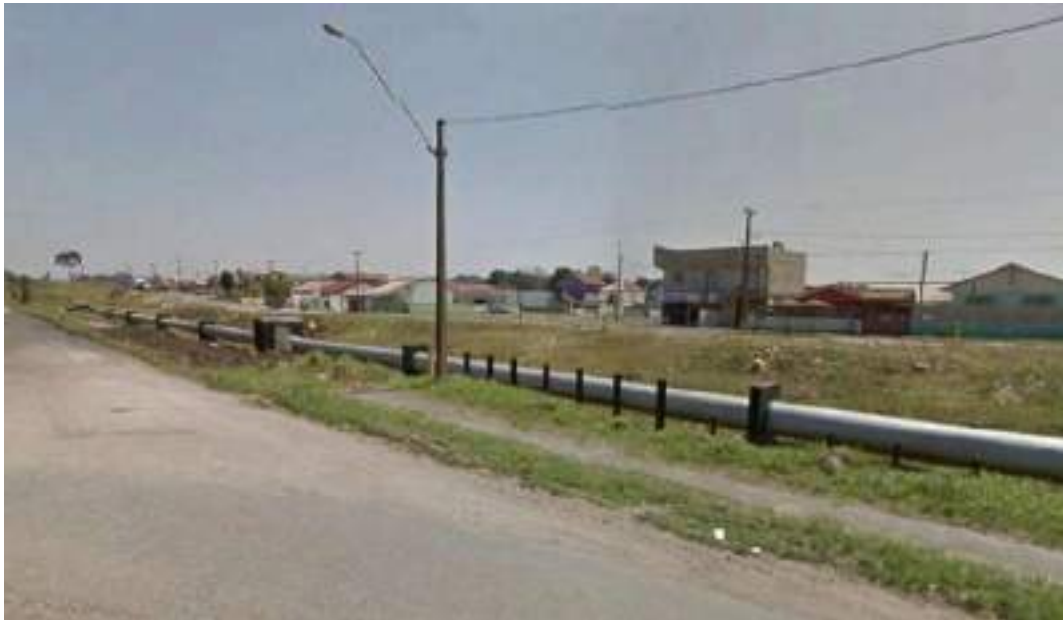
Figura 92: Afloramento do aqueduto na Avenida dos Pinheirais.
