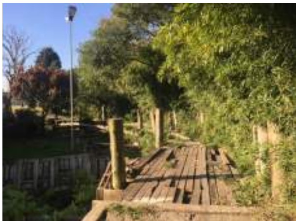
Figura 68: Ponte ao longo do percurso da ciclovias em estado precário.
