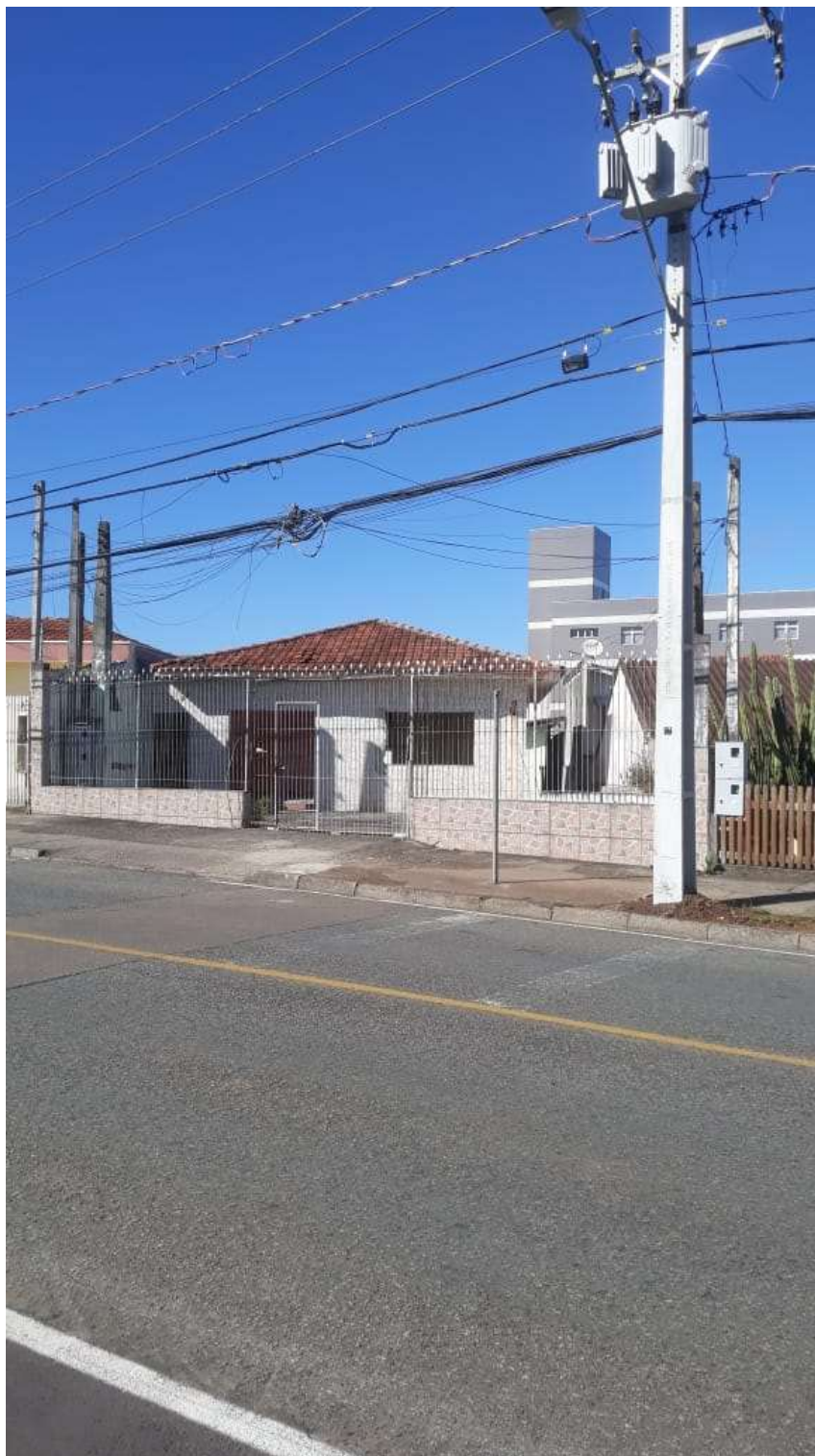
Figura 8: Entrada de energia em média tensão
